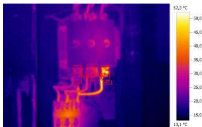
Рисунок 12 – Термограмма магнитного пускателя в распределительном устройстве
