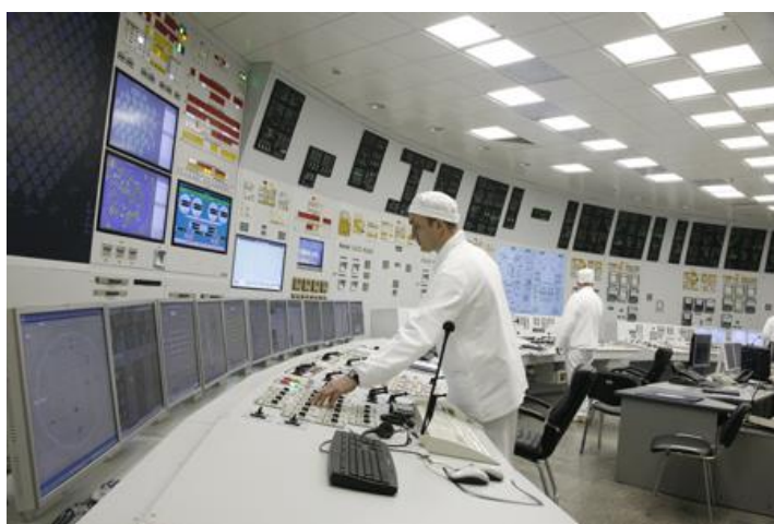
Рисунок 23 – Блочный щит управления атомной электростанции
