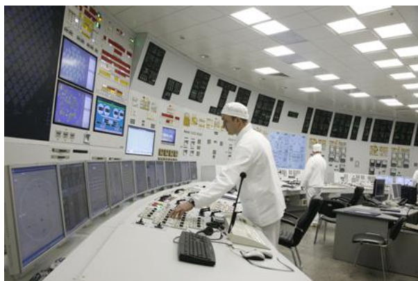
Рисунок 3.4.4 – Блочный щит управления атомной электростанции
