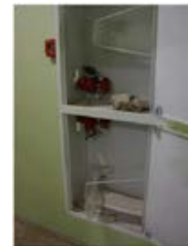
Рис.4. Неисправный пожарный кран в общеобразовательном учреждении:
