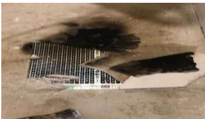
Рис. 3. Иллюстрация термических повреждений, обусловленных тепловым воздействием системы «теплый пол»
