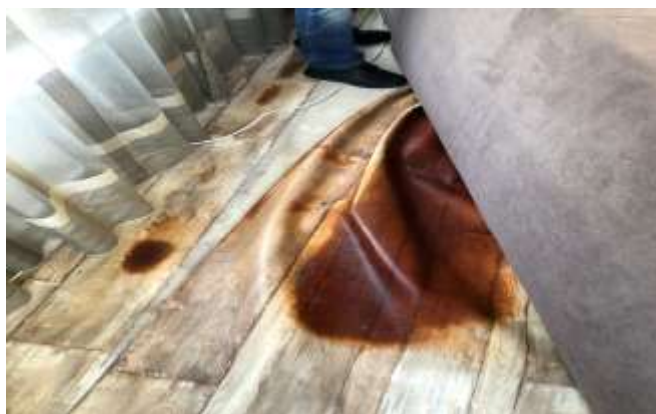
Рис. 1. Иллюстрация термических повреждений, обусловленных тепловым воздействием системы «теплый пол»
