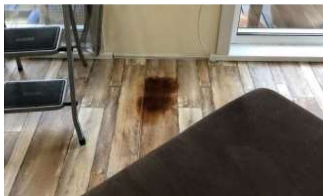
Рис. 2. Иллюстрация термических повреждений, обусловленных тепловым воздействием системы «теплый пол»
