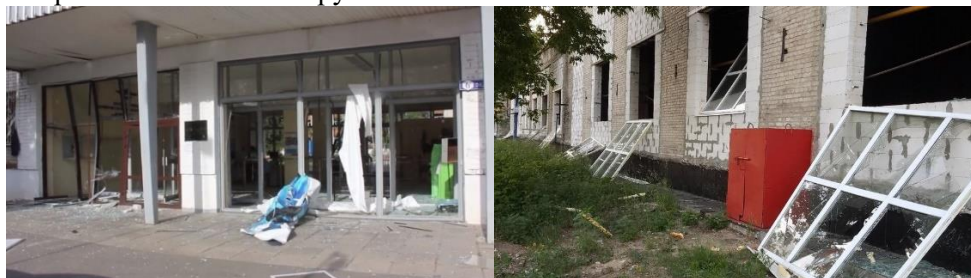
Рис. 1,2. Последствия взрыва на заводе АО «ГосНИИ «Кристалл»
