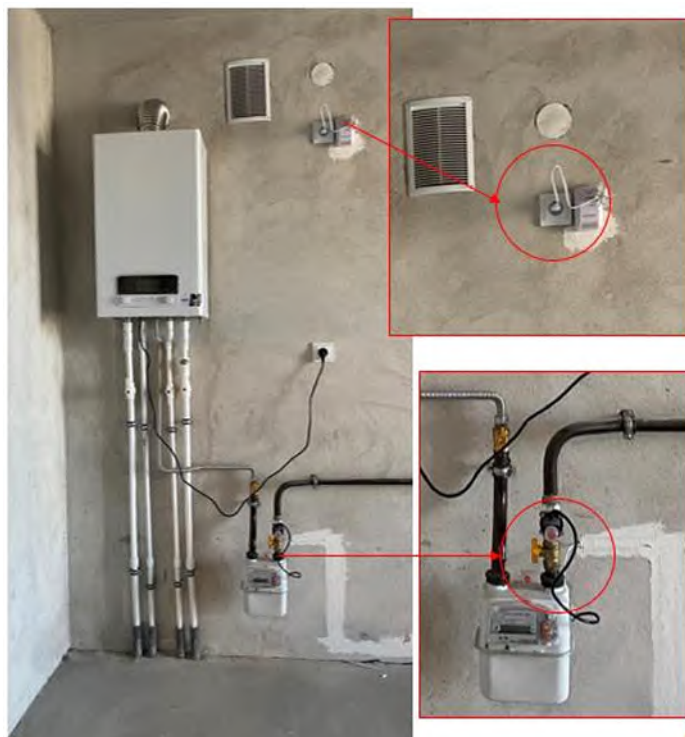
Рис. 5 - Приборы газового контроля, установленные застройщиком в помещении с бытовым газоиспользующим оборудованием
