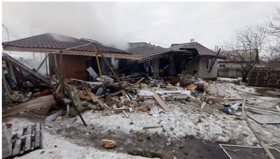
Рис. 2 - Взрыв газа в частном жилом доме пгт. Елань (Волгоградская область) 03.03.2023
