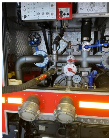
Рис. 9. Подключение разработанного устройства к пеносмесителю автомобиля пенного тушения
